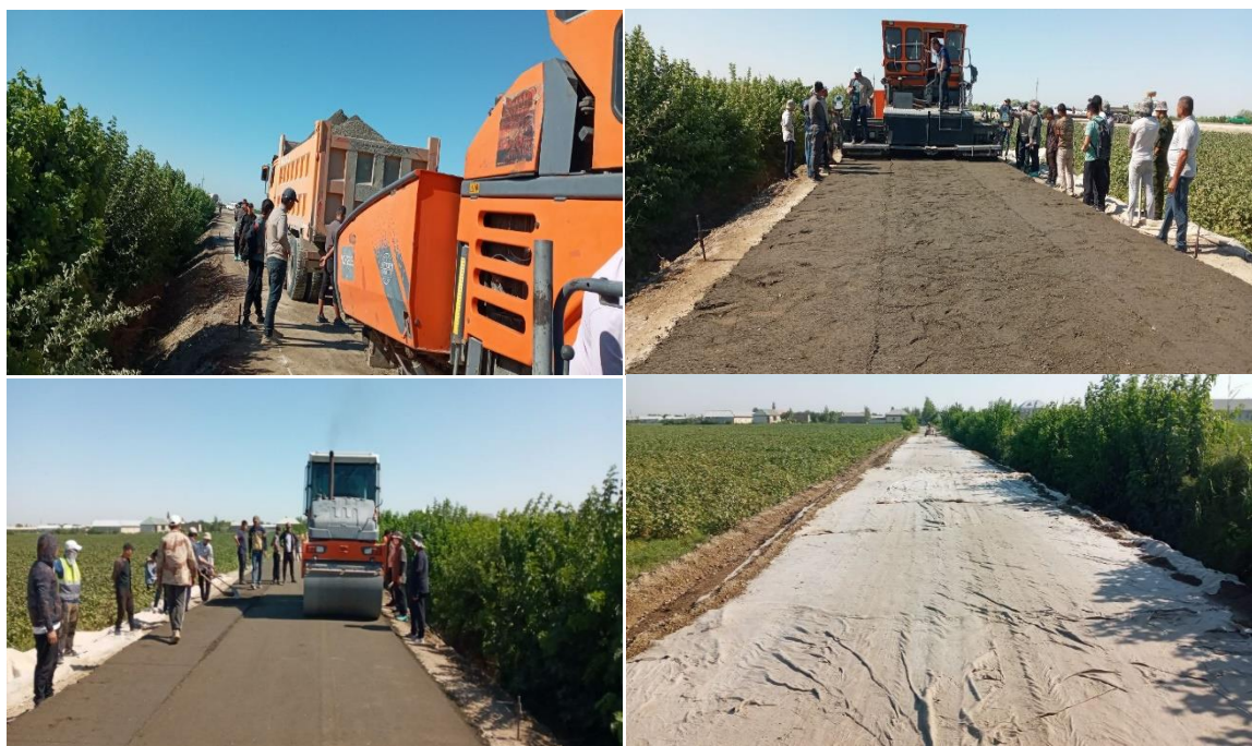
2-rasmda. A-380 “Guzor-Buxora-Nukus-Beyneu” avtomobil yo‘lining PK 228+315 qismiga tutashgan qishloq ichki yo‘liga bosib zichlanadigan beton yotqizish jarayoni
